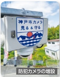
防犯カメラの増設
